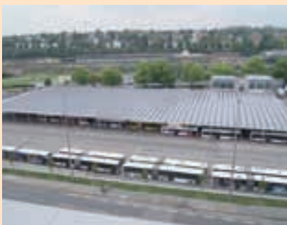
Photovoltaikanlage auf dem Busport
