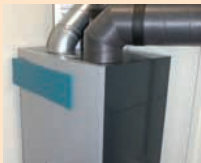
Die neue Lüftungsanlage für den Konferenzraum
